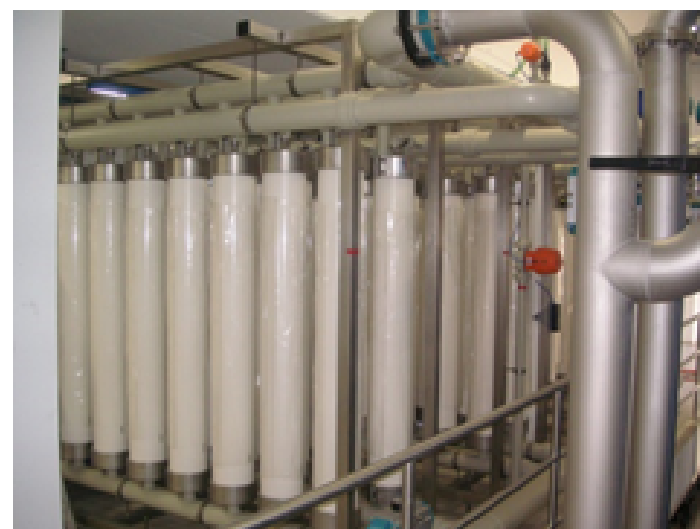
Station d'ultrafiltration du Syndicat des Eaux de Haute-Ajoie à Courtemaîche. Le système d'ultrafiltration du SEHA vise à garantir une alimentation en eau de qualité sur l'ensemble du réseau. En plus du traitement les enjeux techniques résident dans le renouvellement des infrastructures sans interruption de l'approvisionnement. Par son expérience RWB a mis en place un système d'automatisation moderne (vannes commandées par téléphone portable, alerte SMS,...)
